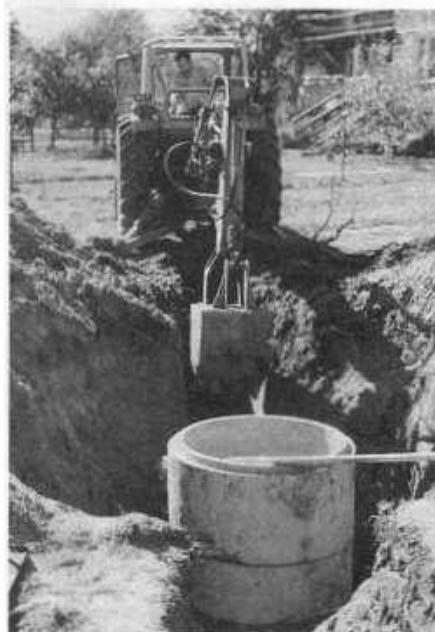
W Trzcianka od 1997 r. są prowadzone roboty przy budowie kanalizacji i jest nadzieja, że w 2000 r. objęta nią zostanie cała wieś.
