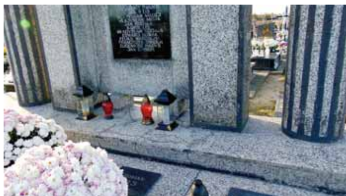
Fragment zbiorowej mogiły z widocznymi uszkodzeniami.
